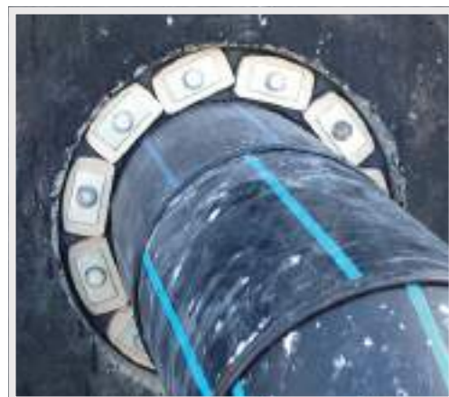
Водопроводные трубы диаметром 315 мм
